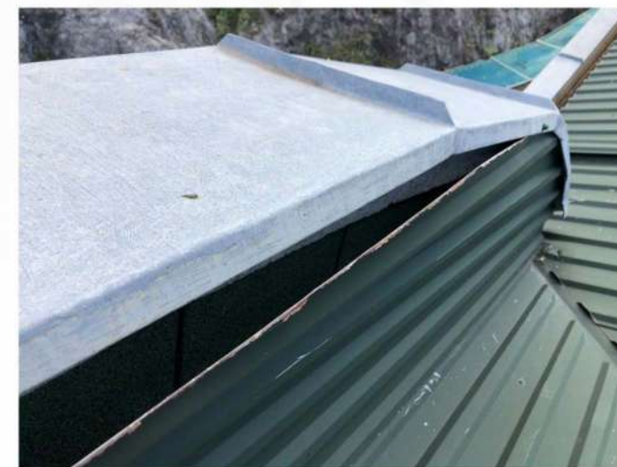
8 Zbog lošeg fiksiranja limova dio lima nedostaje na krovu
