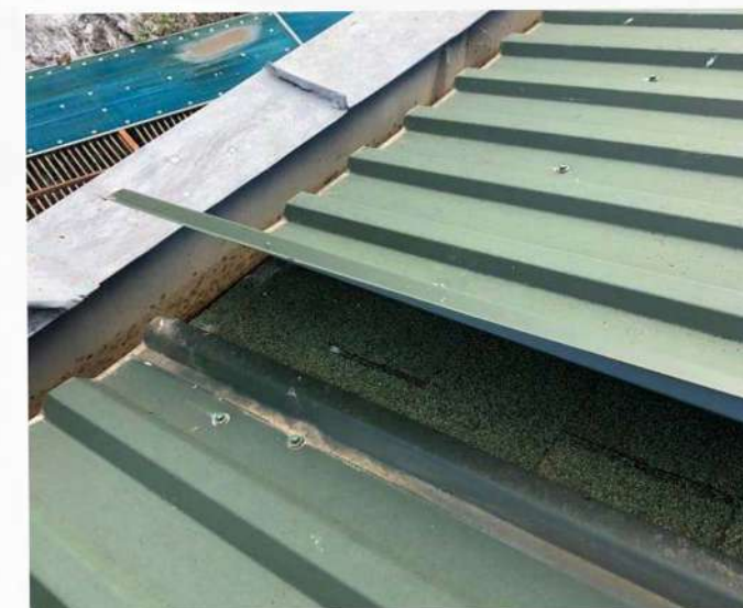
7 Oštećenje krovnog pokrivača
