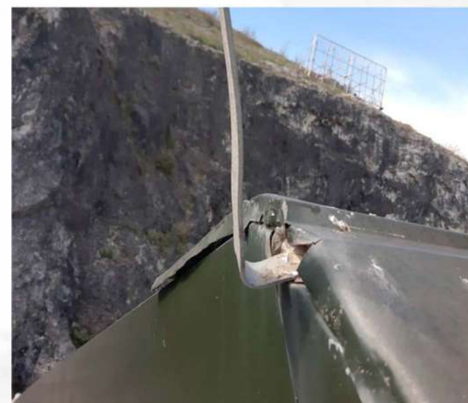
9 Oštećenje šljemena krova i krajnih opšivki
