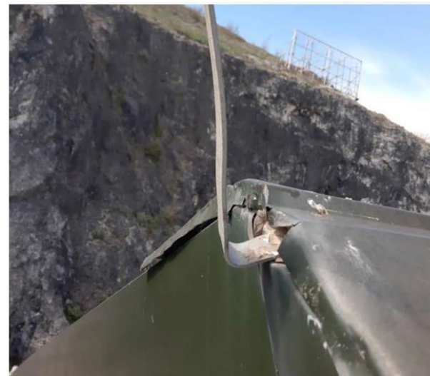
Oštećenje šljemena krova i krajnih opšivki / Damage to the roof ridge and end
