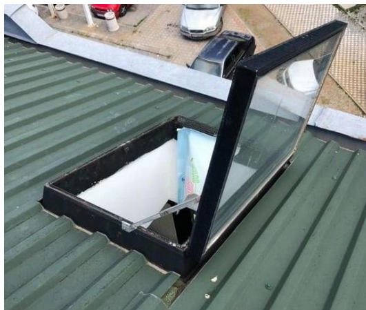
Nedostatak opšivki krovnog revizionog otvora/ Lack of heming on the roof opening
