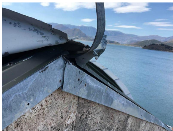
Oštećenja šljemena krova i krajnje opšivke/ Damage to the roof ridge and end trim
