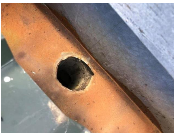
Oštećenja hidroizolacije u olucima/ Waterproofing damage in gutters
