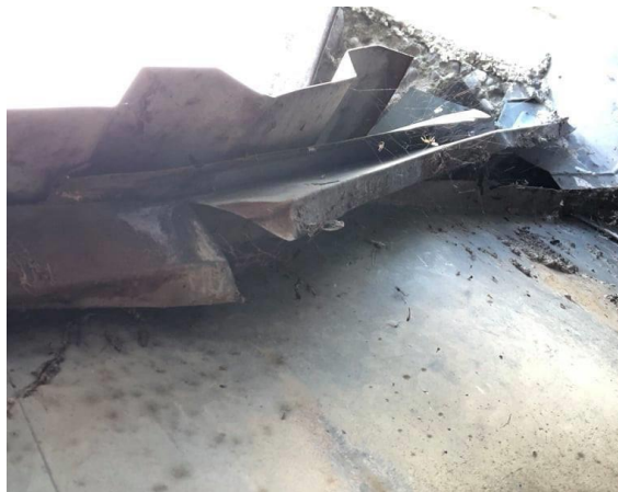
Oštećenje vodnih limova/ Damage to water sheets
